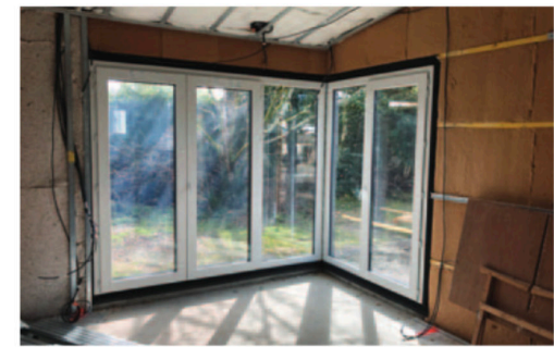
Les menuiseries EnR sont installées dans les pièces sèches en entrée d'air de la ventilation simple flux, comme ici sur deux vantaux du salon salle à manger.
